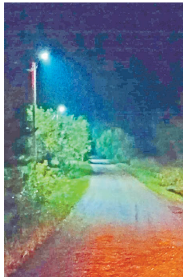
Освещение в д. Авдотьино.
