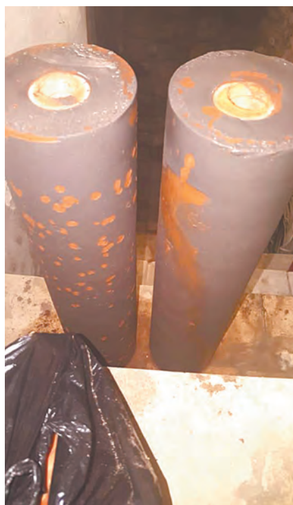
К ржавчине на входных фильтрах жители Жерело почти привыкли.
