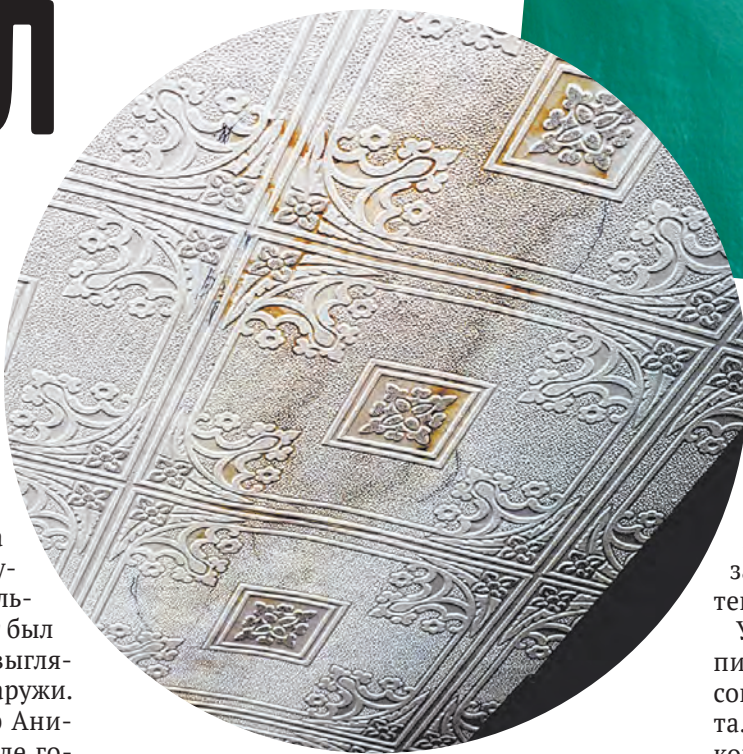
Подтёки на потолке в кв. 20.
