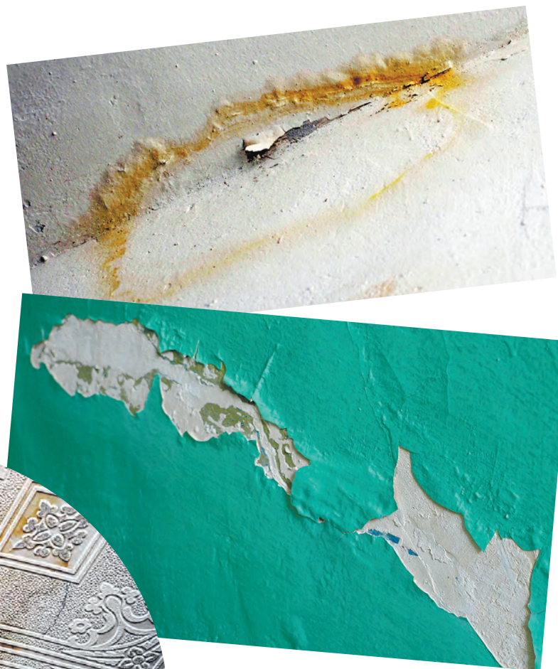
Подтёки и обвалившаяся штукатурка в подъезде.
