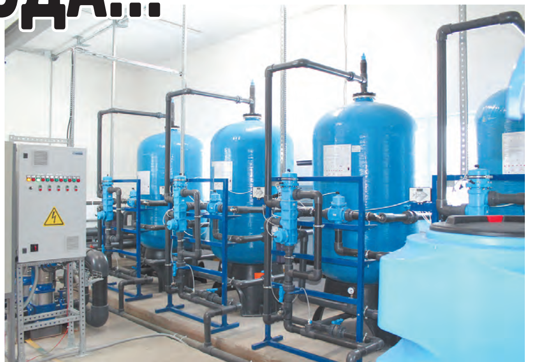
Станция очистки воды в Жиздре.
