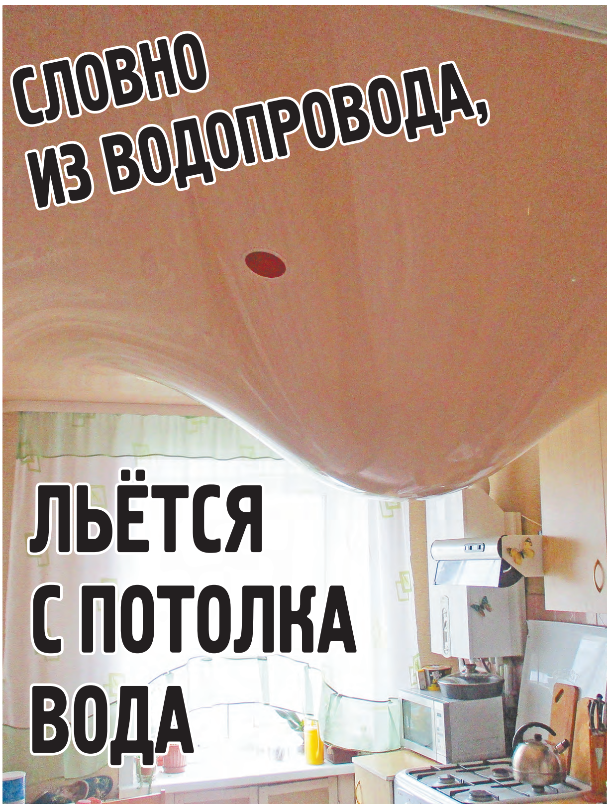
После капитального ремонта в крыше одного из многоквартирных домов Людинова открылась течь
