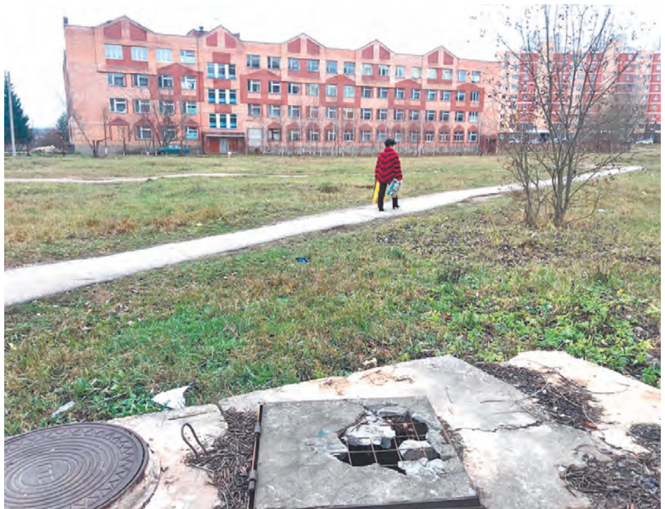
Разрушенный люк возле калужской школы № 51.
